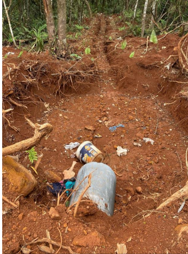
Figura 06 – Vala de drenagem realizada além do dissipador na Rua Flori de Souza
