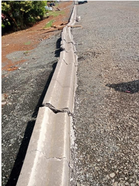
Figura 34 – Meio fio extrusado danificado pelos moradores
