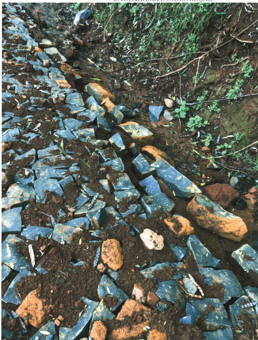
Imagem 06: Pontos de erosão causados por enxurradas
