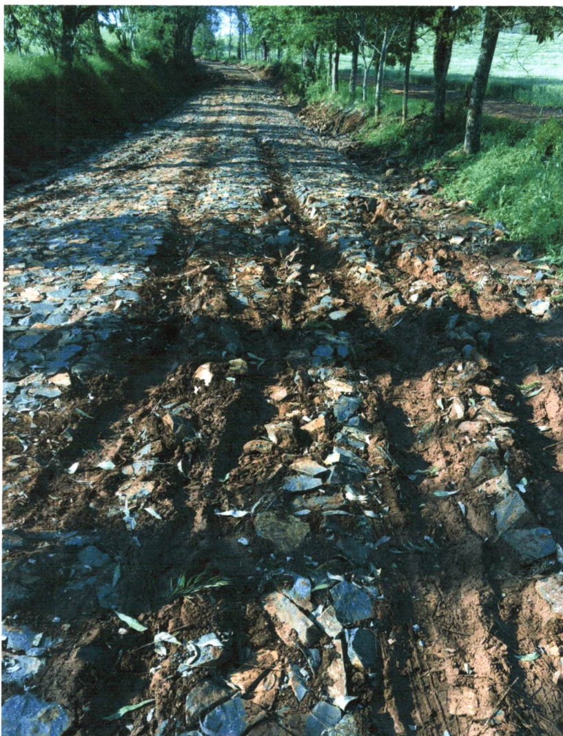
Imagem 01: Danos causado por veículo
