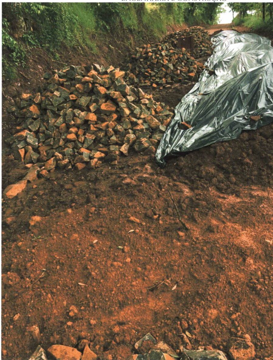
Imagem 07: Umidade causada pela chuva e vertentes
