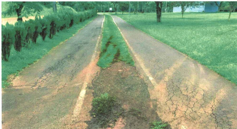
FOTO 02 – afundamentos e trincas em área não prevista em projeto.
