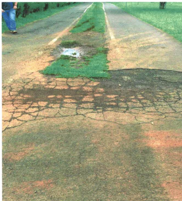
FOTO 03 – afundamentos e trincas em área não prevista em projeto.
