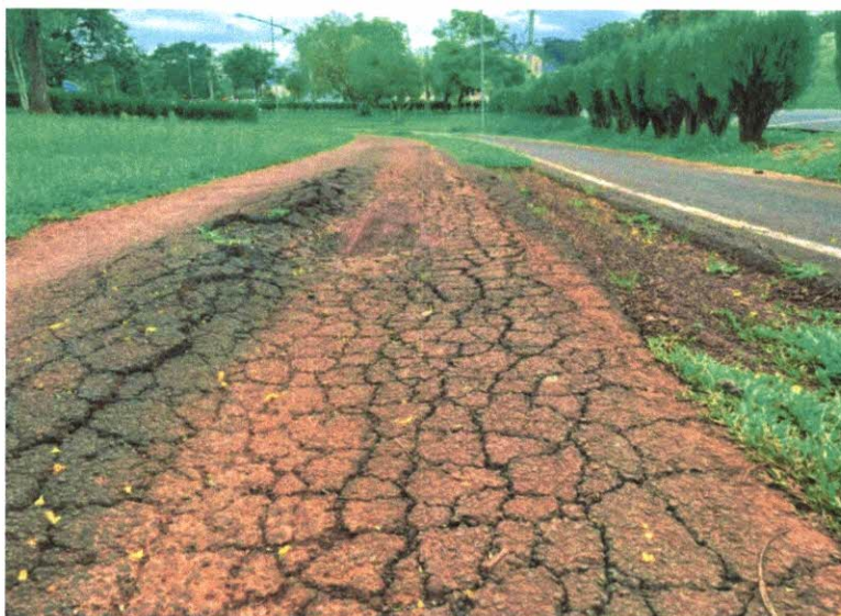
FOTO 01 – área não prevista no projeto, com deformação e trincas.
