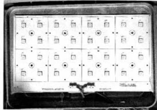
IPX6 - Evidência de NÃO ingresso de água no compartimento óptico da luminária
