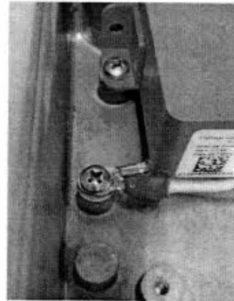
Conexão de aterramento
