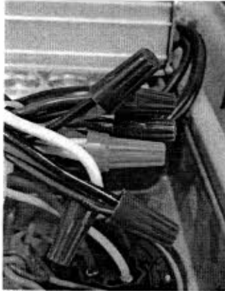
Conexões internas da luminária
