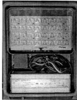
Vista interna da luminária
