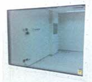
Imagem 59: Visor plumbífero das salas de raio-x e tomografia.
