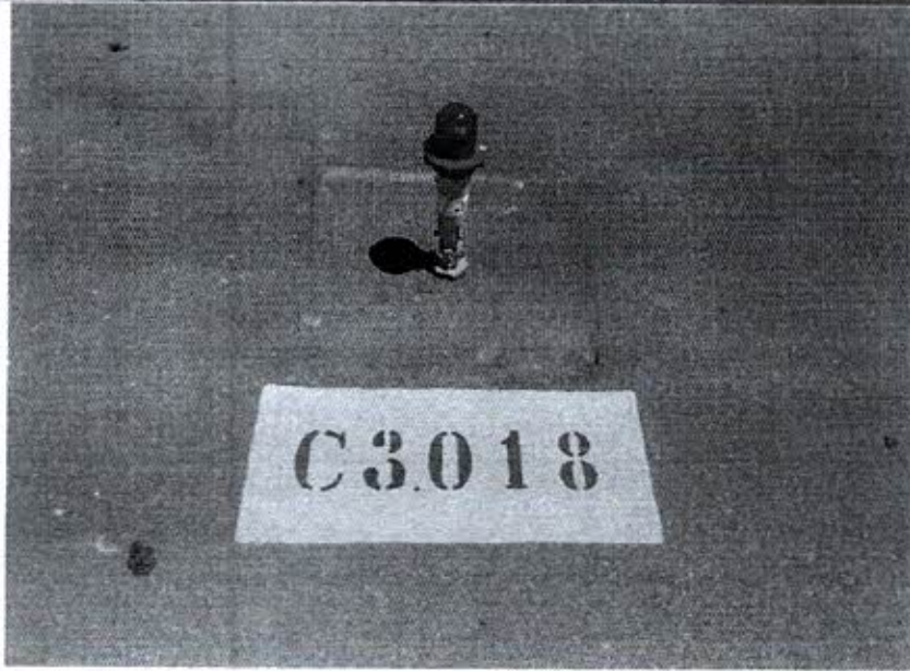
Foto 31: Luminária de balizamento de pista de taxi
